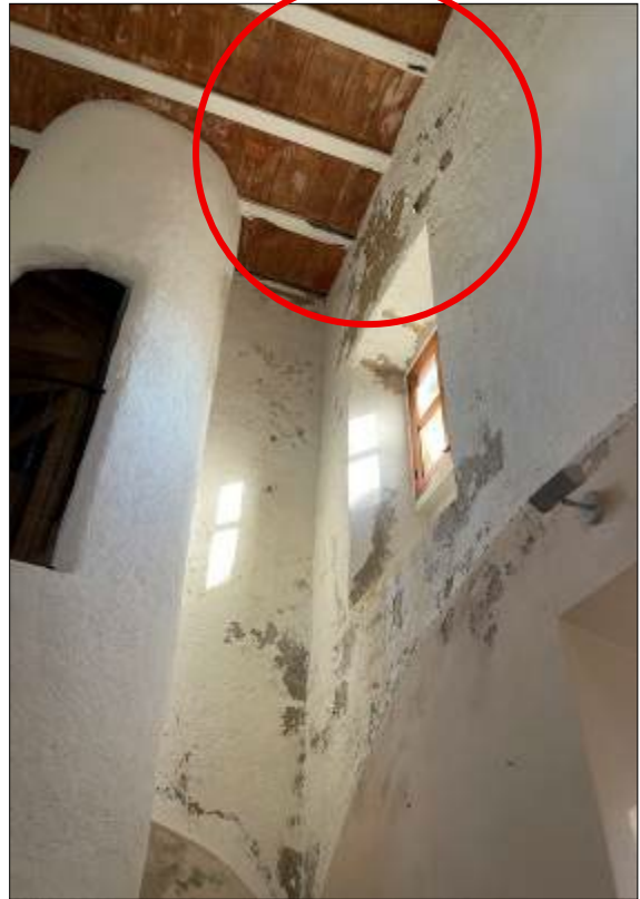
Bigues en mal estat de conservació
