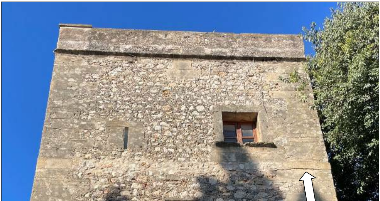
Fissura a un tirant.
