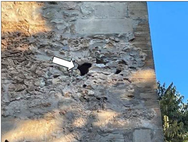
Zona buidada de pedra i morter. Es detecten moltes juntes de morter de ciment
