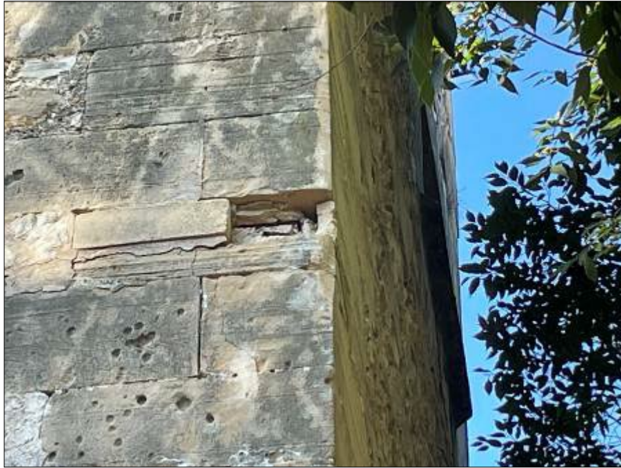
Despreniment d'una peça que recobria part d'un tirant
