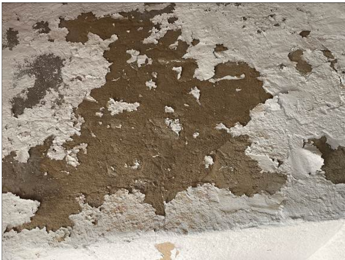
Revestiments interiors en mal estat de conservació
