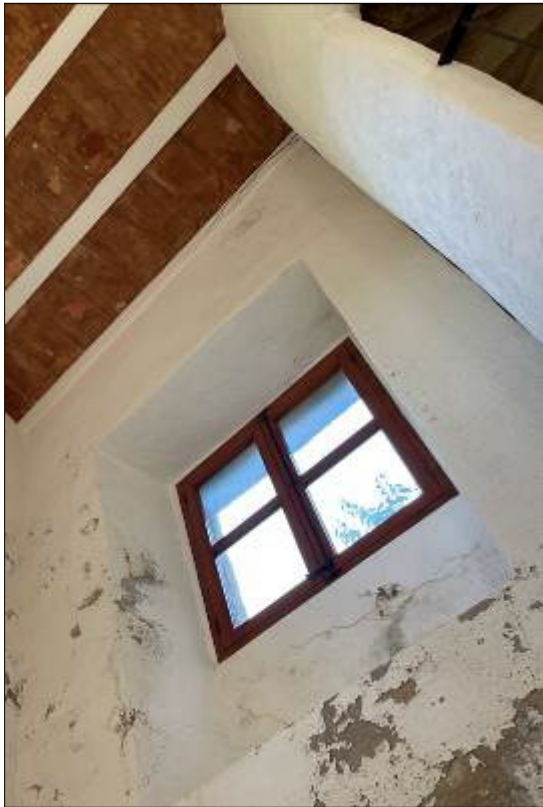
Revestiments interiors en mal estat
