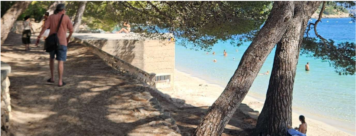
Punt de descàrrega d'aigües pluvials.
