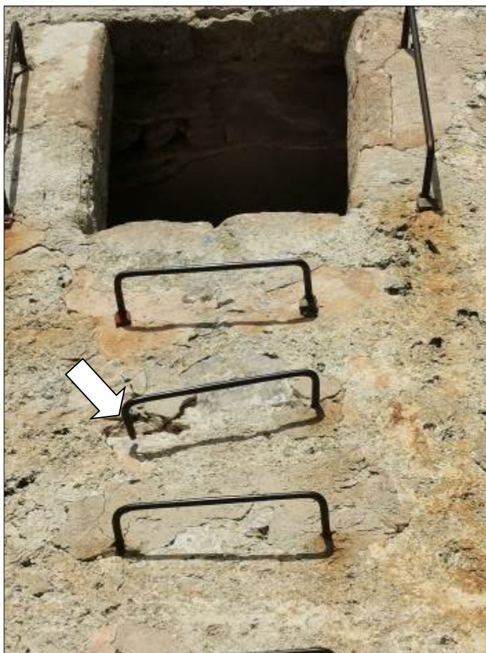
S'observa una fixació inestable i escorrenties amb tincions
