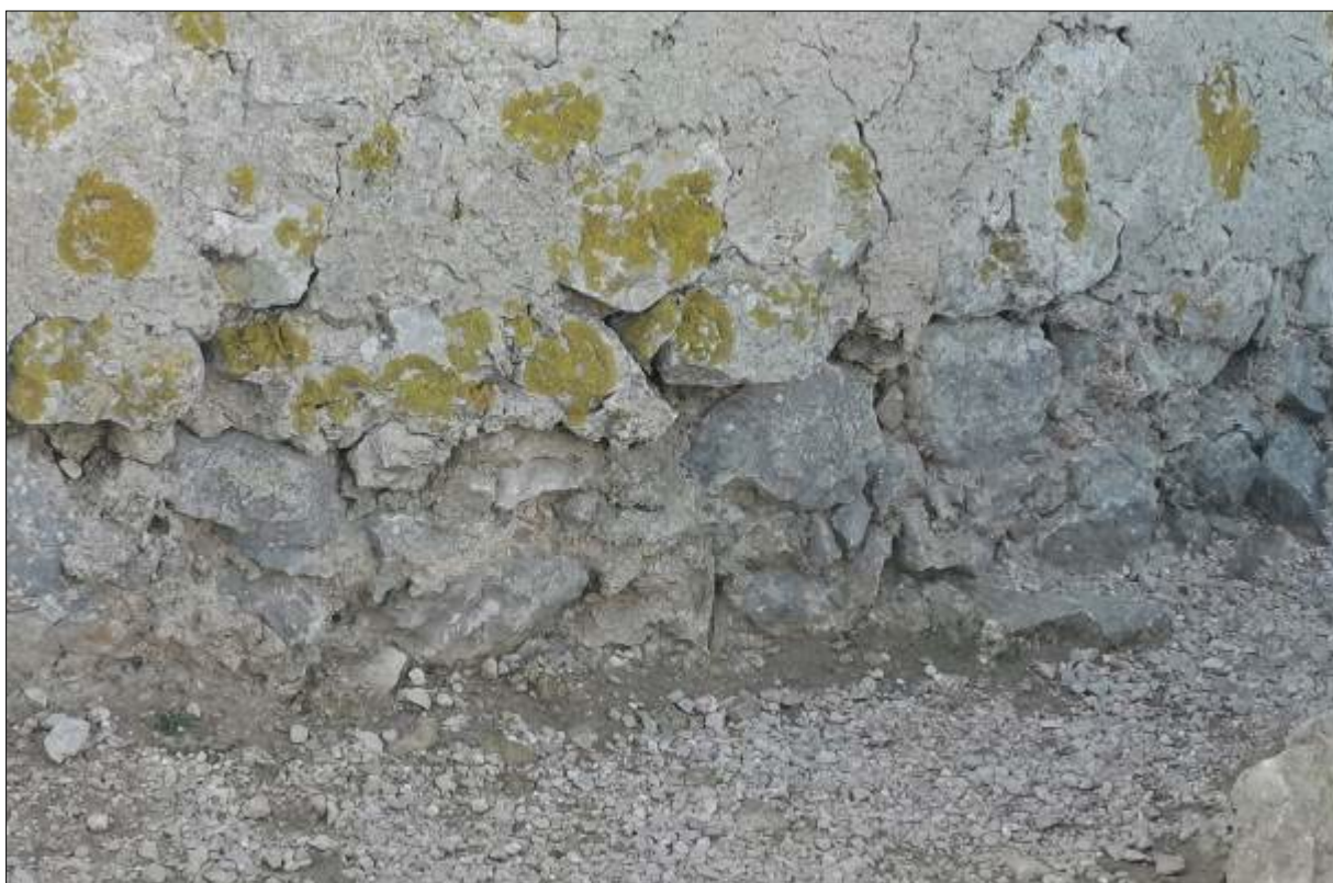
Pèrdues de volum a la zona inferior de la torre que afecten a les juntes del paredat i al revestiment
